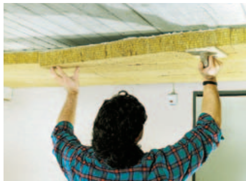
Anschließend wird Planarock mit Hilfe eines Reibbrettes angesetzt und an den Untergrund angedrückt, um sie in ihrer endgültigen Lage sicher zu verkleben.
